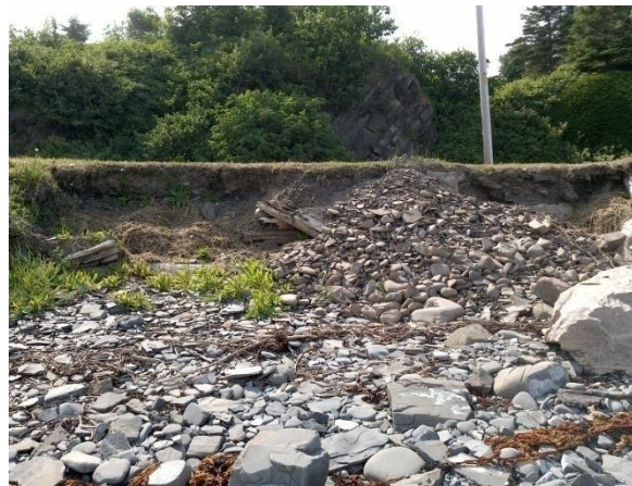
1.10. Érosion de la rive (plage ouest)
