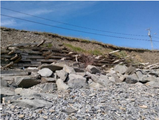
7.9 Enrochement et structures en bois abandonnées
