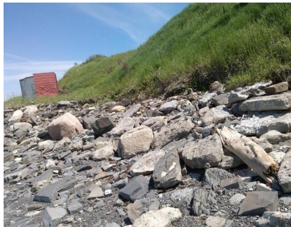
2.6 Ancien enrochement et cabanon abandonné
