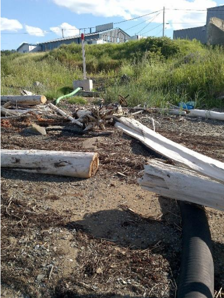
17b.7 Système de pompage de l'eau de la baie
