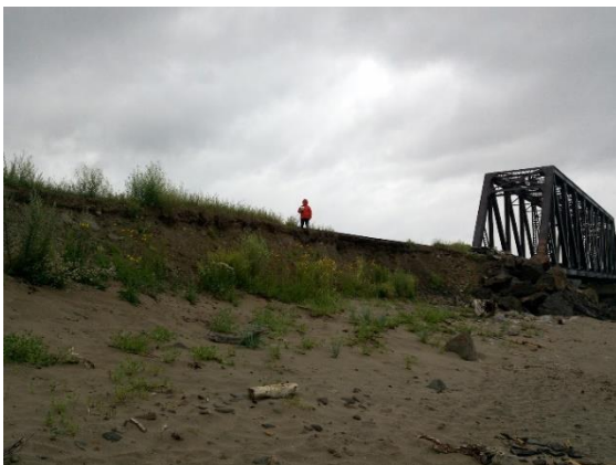
18.11 Érosion du remblai sous la voie ferrée
