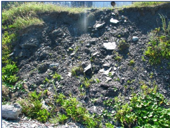
A- Érosion et décrochement de talus
