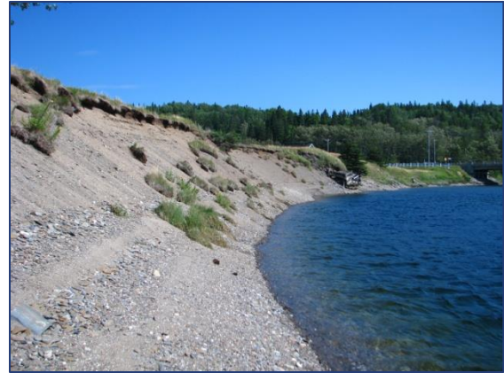
B- Érosion des berges de la rivière
