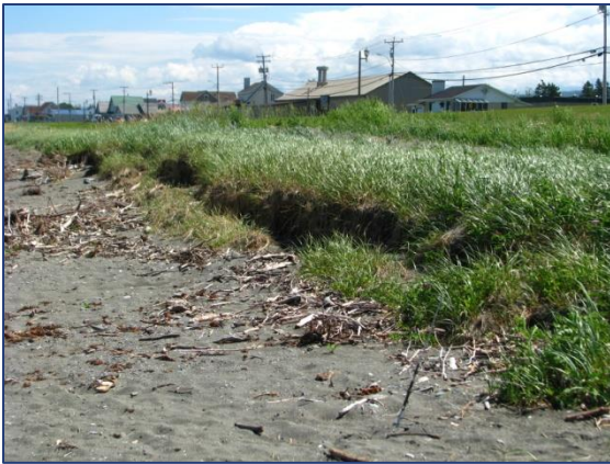
A- Érosion et décrochement de talus
