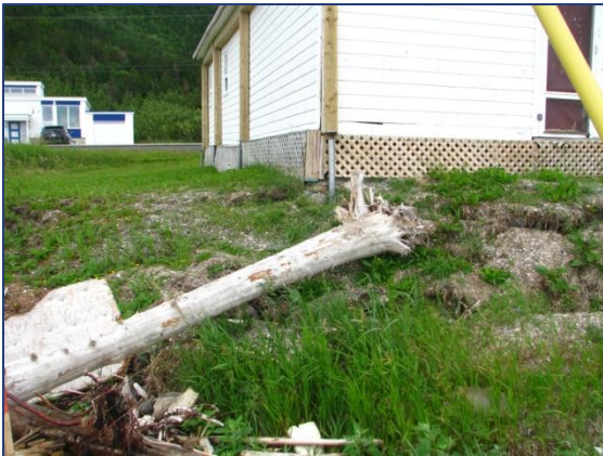
C- Érosion sur le coin d'une habitation
