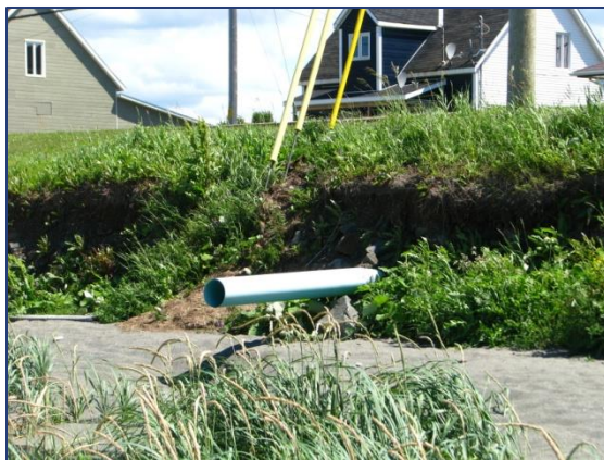
C- Tuyau d'évacuation et érosion
