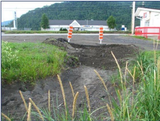
A- Érosion et décrochement de talus
