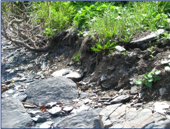
C- Érosion de la côte
