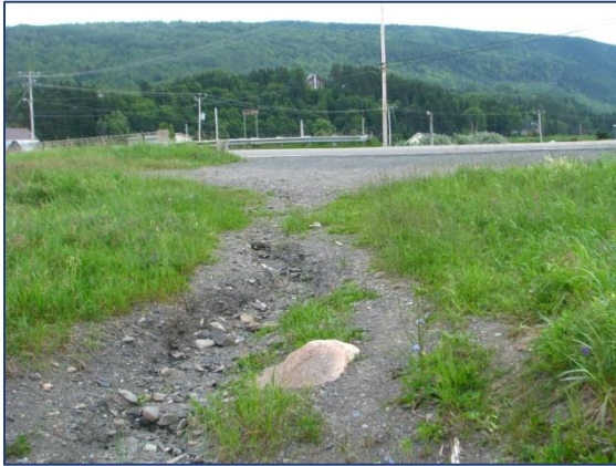
A- Érosion du talus
