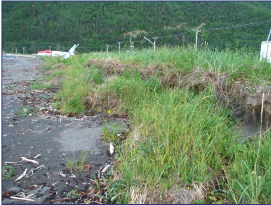
A- Érosion et décrochement de talus
