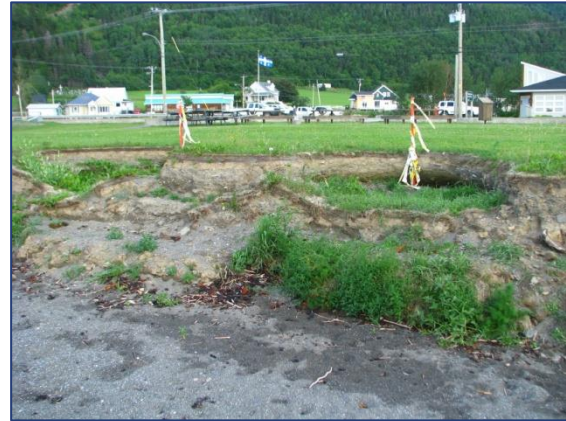
B- Décrochement de talus
