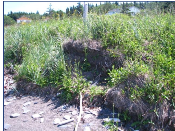
B- Érosion et décrochement de talus
