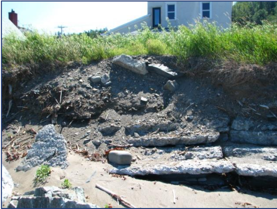
A- Érosion et décrochement de talus
