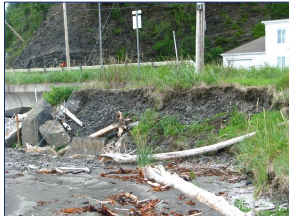
D- Érosion près d'un poteau électrique
