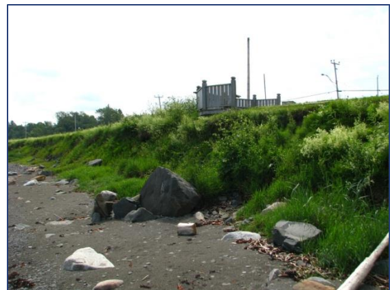
F- Station de repos touchée par l'érosion
