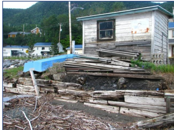
B- Érosion d'un muret
