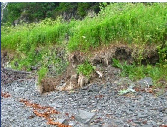
E- Érosion et décrochement de talus
