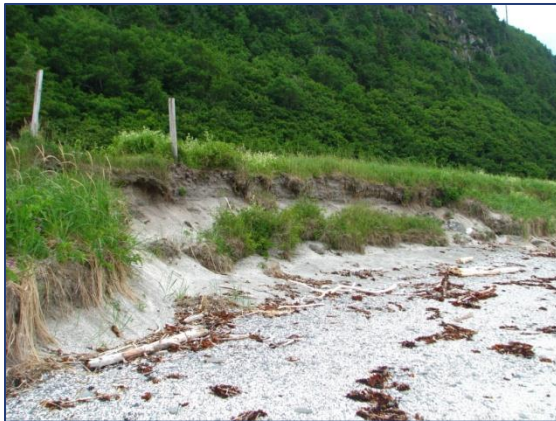
A- Érosion et décrochement de talus
