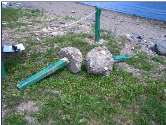
C- Effet de l'érosion sur une clôture
