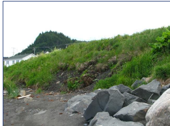
B- Érosion et décrochement de talus
