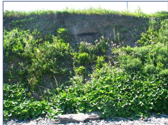
B- Érosion et décrochement de talus
