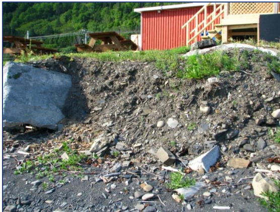
A- Érosion et décrochement de talus
